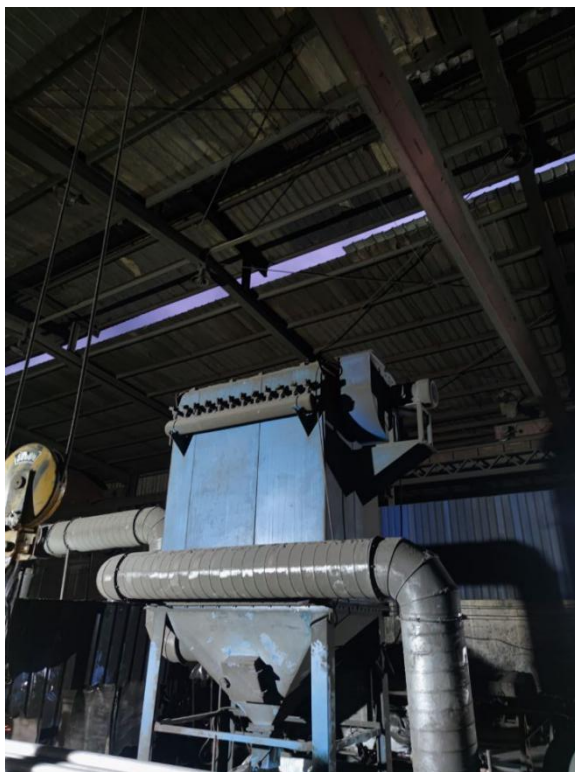
布袋除尘废气处理设施
